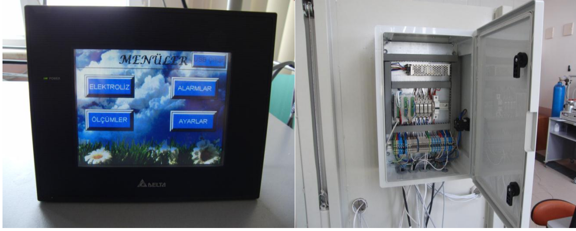
Fotoğraf 3.4 PLC ekranı ve data logger/kontrolör sistemi
