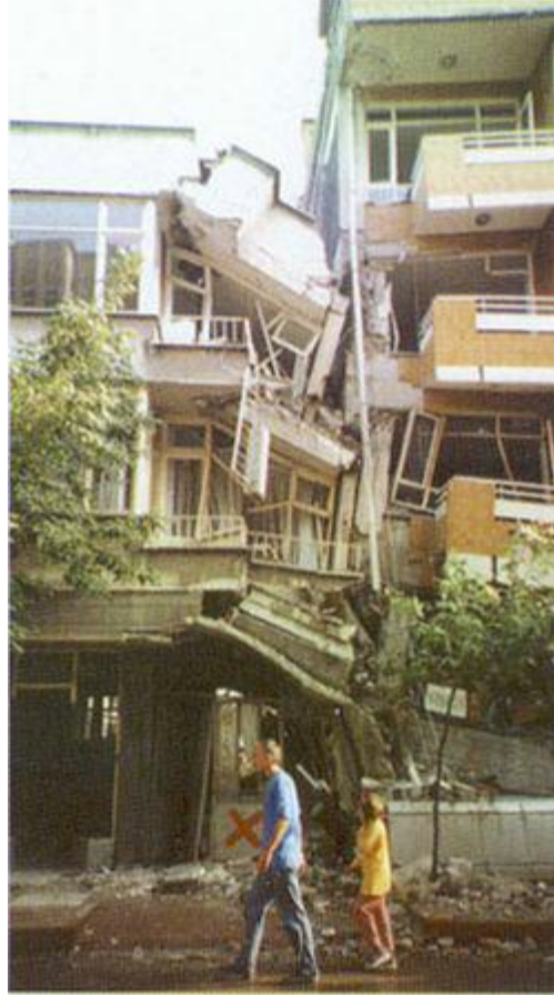
Şekil 1.17. Farklı yükseklikteki bitişik yapıların çarpışması-Gölcük, 1999 (Pampal, 2000)
