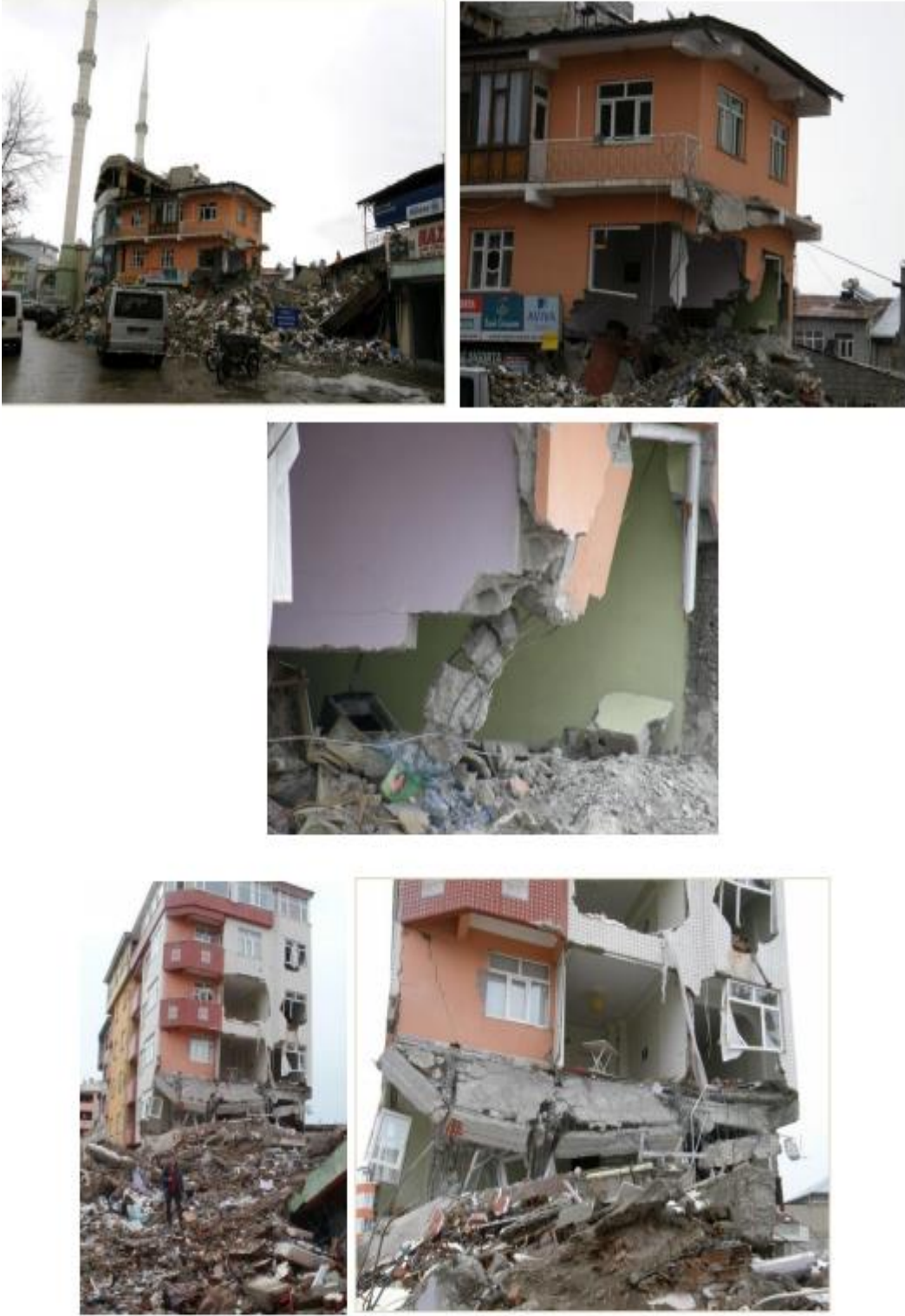
řekil 1.16. Erciř'te çok katlı bir binanın yıkılma anında yanındaki sağlam binaya çarpması ile oluşan hasar (Önen vd., 2012)
