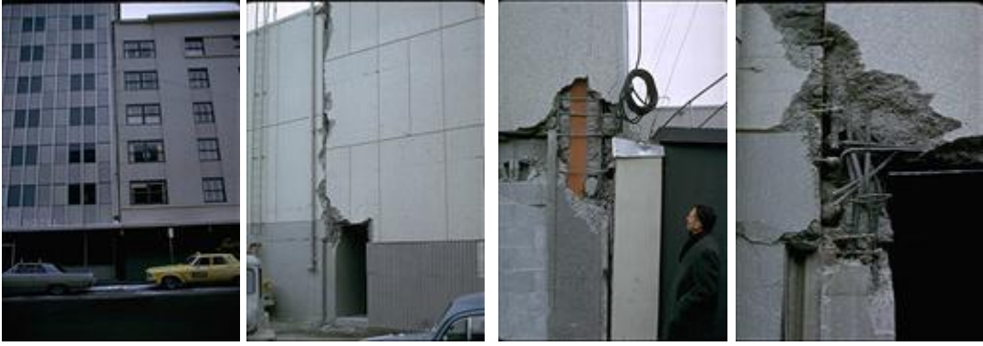
Şekil 1.3. Anchorage-Westward Hoteli ve West Anchorage Lisesinin derzleri arasındaki çarpışmadan kaynaklanan hasarlar (NİSEE e-Library)
