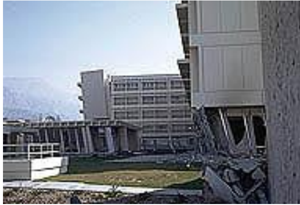
Şekil 1.4. Olive View hastanesi ve ek bina Stairway Tower arasında oluşan çarpışma hasarı (NİSEE e-Library, 2015)
