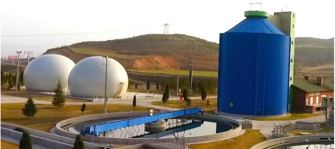
Şekil 3.4. Çürütücü tankı ve gaz depolama balonları (Atıksu arıtma dronla çekim, 2018)
