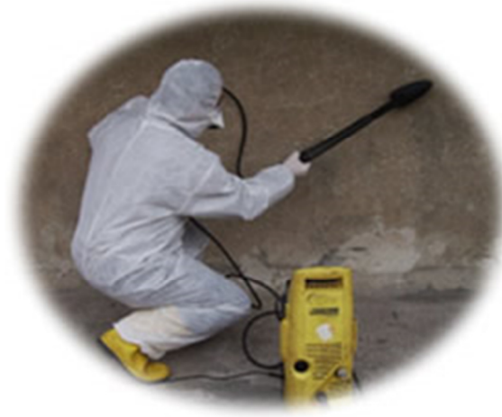
Şekil 2.13. Depo ilaçlanması( http://www.temizilaclama.com ).
