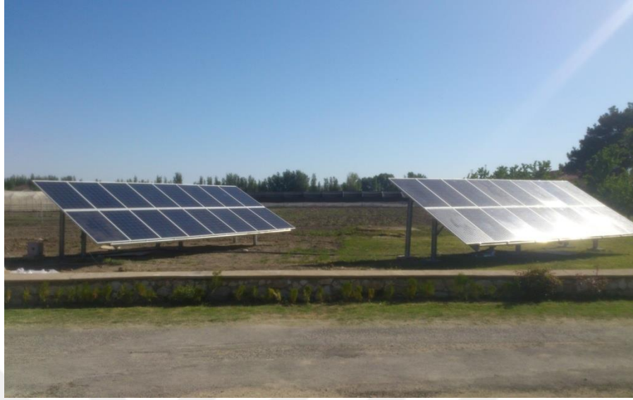
Fotoğraf 4.1. Fotovoltaik paneller
